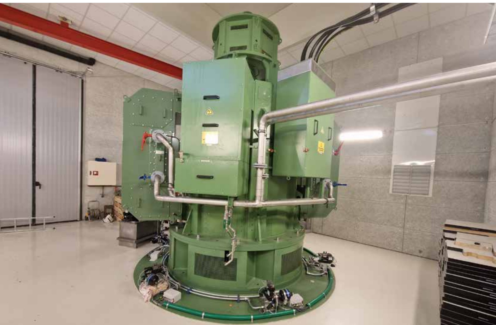
Generator Riksheim Kraftstasjon
